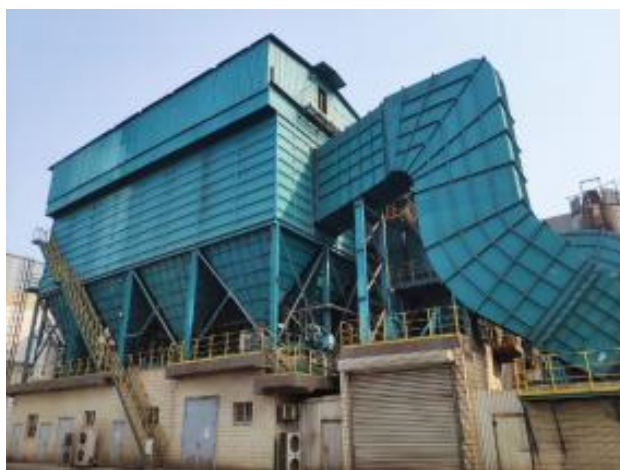
电炉烟气袋式除尘
