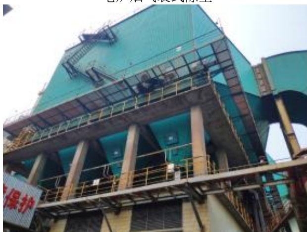
400m 2 烧结机头四电场静电除尘器
